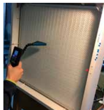
Ett av flera viktiga moment i CTCB-Certifieringen handlar om hur man på korrekt sätt kontrollerar funktionen hos HEPA-filter. Foto: Lars Ekberg.
